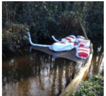
Barrage flottant sur l'Aurence afin de confiner la pollution industrielle
